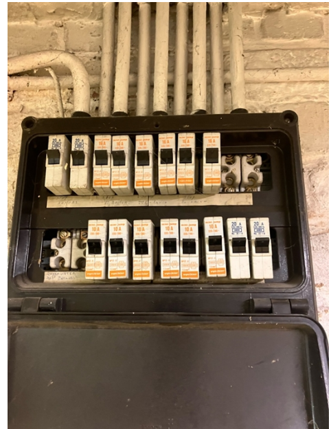
( Elektrisch bord - binnenkant )
